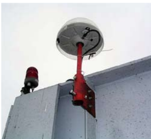
Rys. 5. Sposób zamocowania anteny GPS na szczycie wieży szybu S1.3 Figure 5. The mounting of the GPS antenna on top of the tower shaft S1.3
